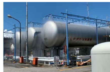
液化石油设备 冷却系统
