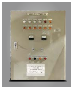
保安ポンプ操作盤
