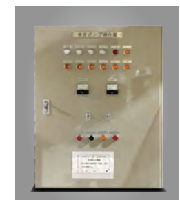
保安ポンプ操作盤
