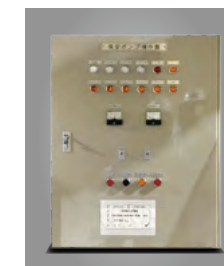
保安ポンプ操作盤
