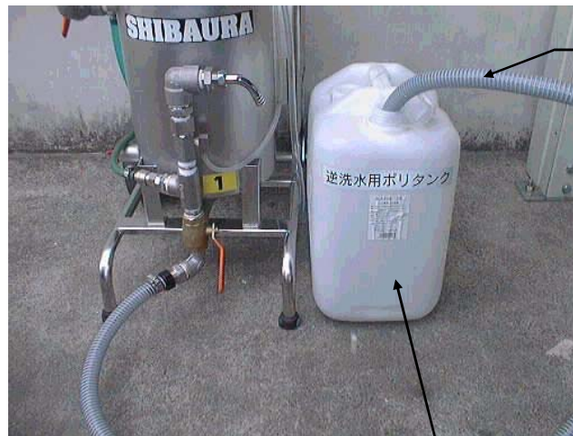
逆洗水用ホース
